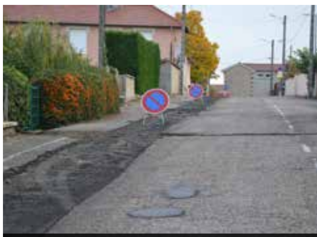
Une nouvelle canalisation d'eau potable a été posée sur toute la longueur de la rue.
