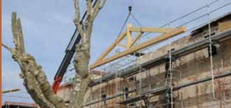
Pour la mise hors d'eau du corps de logis du 19 e siècle, une nouvelle charpente a été fabriquée.
