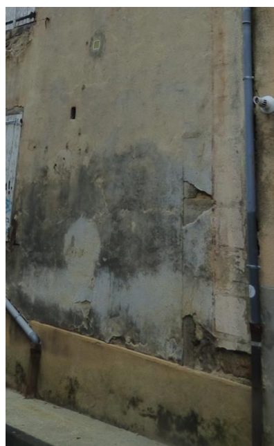
Dégradations des enduit liées aux remontées d'humidité (ex. à Montbrison)
