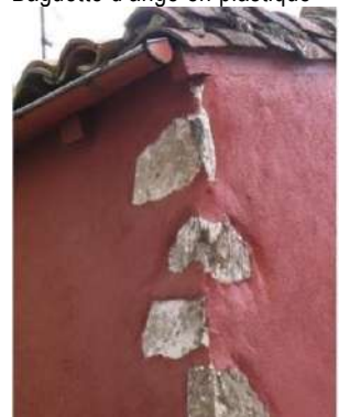
Mise en œuvre et teinte non adaptée : angle irrégulier à couvrir
