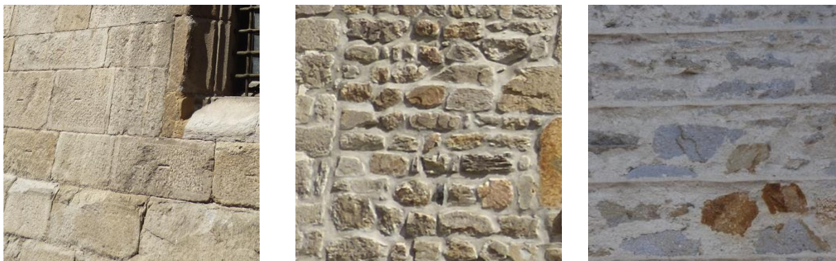
1- Façade en pierre de taille à ne pas enduire ; 2- Façade en moellons à enduire, 3- Façade à enduire à pierre vue (fin 19 e )
